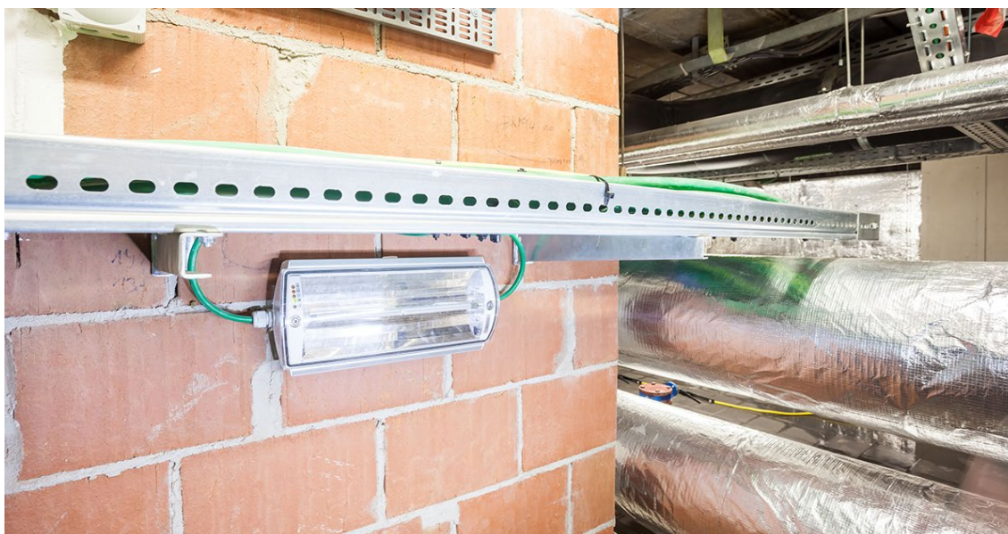
Figura 3.12 - Instalações precárias de um estabelecimento de A&B
